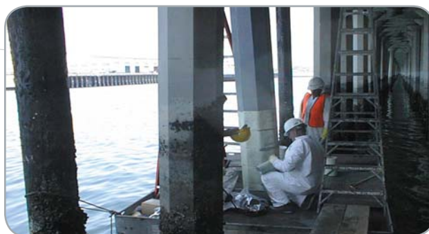
Мост «Френдшип Трэйл», Флорида — ослабление коррозии
