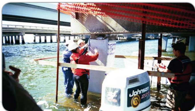
Мост Френдшип Трейл, Флорида — ослабление коррозии
